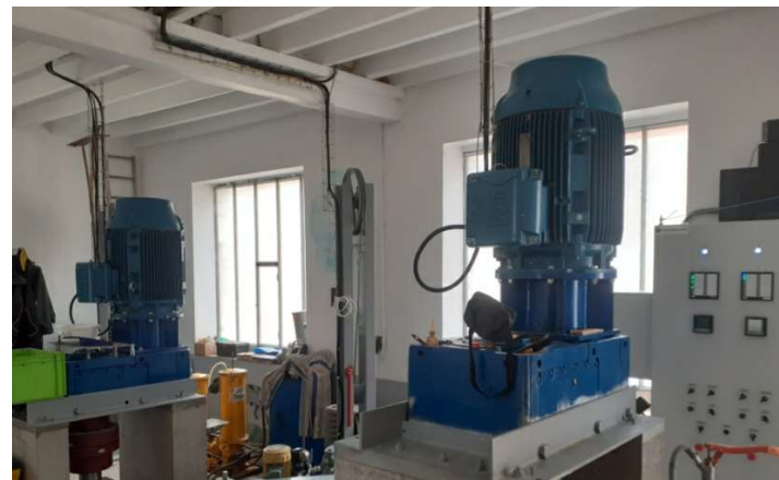
Salle des machines de la centrale de Dannemoine
